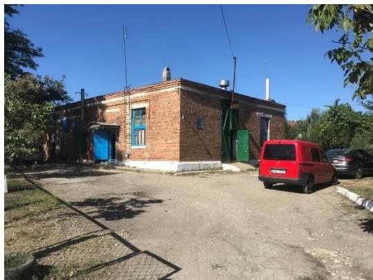
Figură 1. Stația de pompare a apelor uzate Bulboaca
